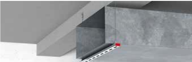
HVAC: descuelgue de conducto rectangular
